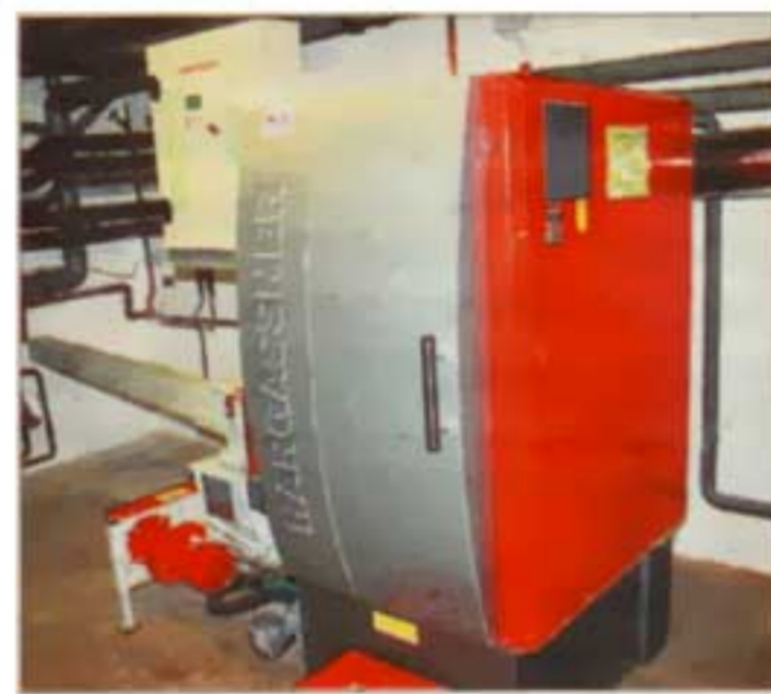
In Poppes Keller: Diese Hackgut-Heizung kann mit Elefantengras betrieben werden.
